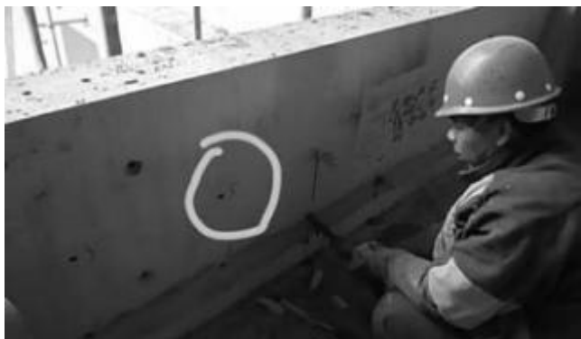
图 2 出浆口不出浆,灌浆套筒可能存在堵塞
